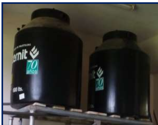
Figura 05. Tanques Eternit, para el sistema el abastecimiento de agua.
